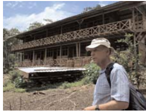
Douglas McMeekin, der Initiator des Schulprojekts, vor dem Rohbau der neuen Schlafräume für die Schüler
