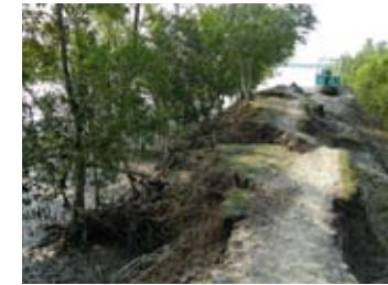
Erodierte Dämme in den Sundarbans müssen dringend ausgebessert werden
